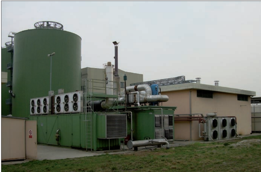
Fig. 2 – I cogeneratori a biogas
